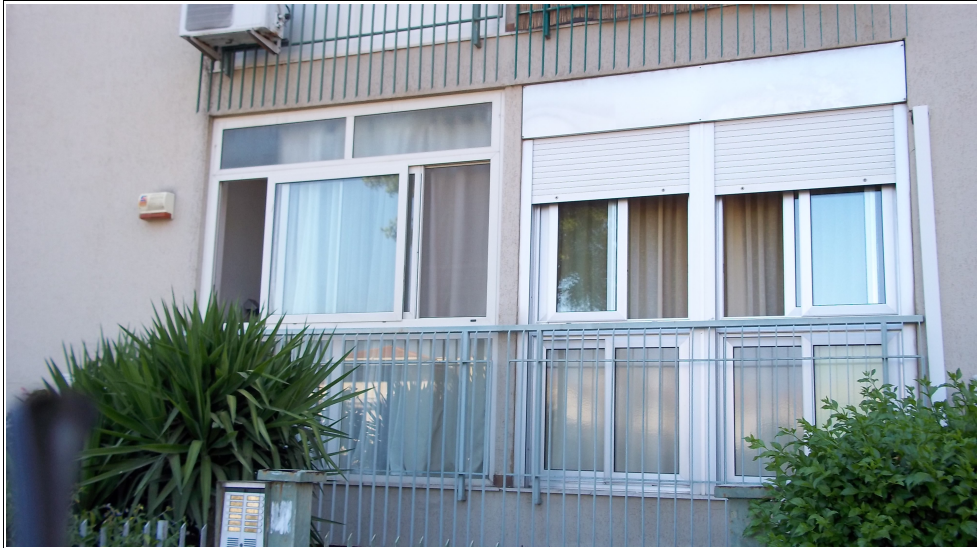
6) Terrazzini chiusi con strutture precarie
